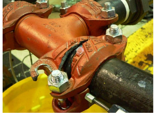
(d) Fracture of coupling flange initiated from the coupling hole
